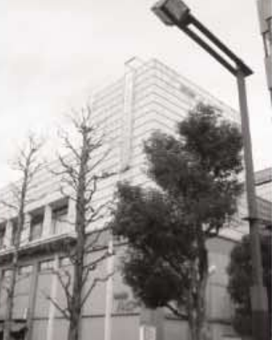
秋川駅北口にされたLED道路灯
